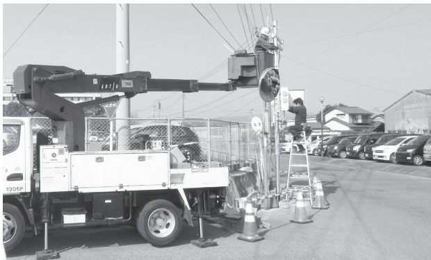
街頭防犯カメラ設置写真
